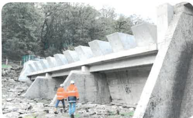
hausses fusibles - barrage de Tréauray
