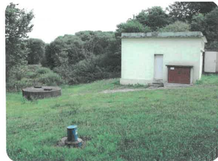
Puits et forage de Moulin de Conveau à Gourin
