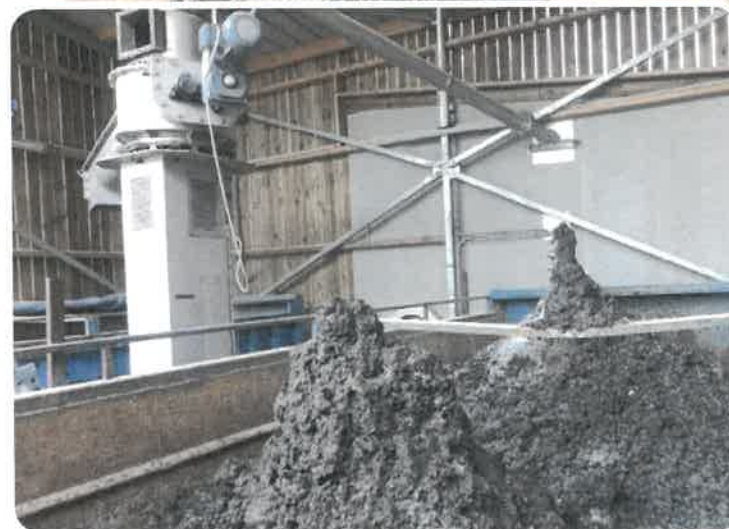
nouvelle unité de déshydratation des boues - unité de production du Lac au Duc - Ploërmel
