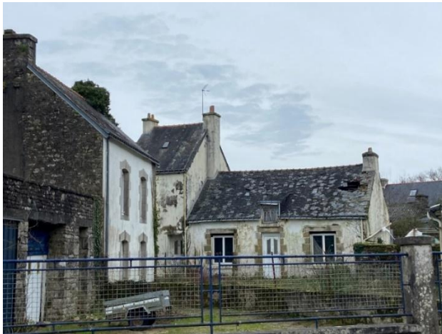
Une maison nécessitant d'importants travaux ; Commune de Le Croisty
